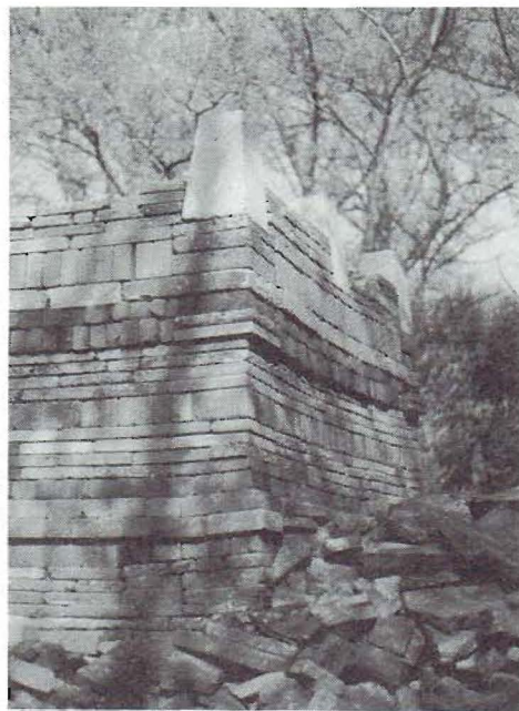
Fragment van het fundament van de eco-kathedraal in Mildam foto: Ben Veld
